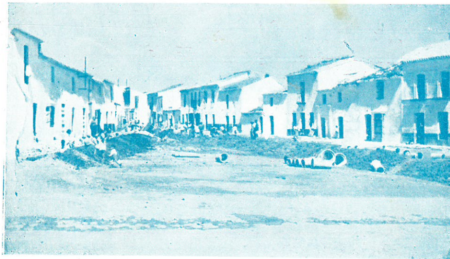
Aspecto que ofrecía la calle General Queipo, con motivo de las obras de alcantarillado emprendidas por el Municipio, para mitigar el paro obrero sobrevenido como consecuencia del temporal de lluvias del pasado invierno.
